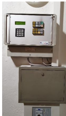
Glockenautomat und Steuerung
