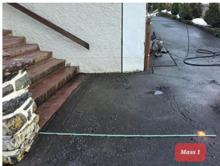
Rohrleitungsbruch vor Kircheneingang
