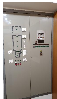
Bedientableau Heizung, Licht
